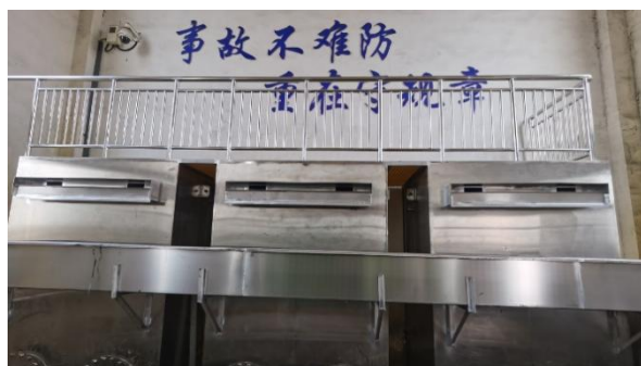
纺织园水厂同步除硬度、铁、锰、氨氮装置正面图
